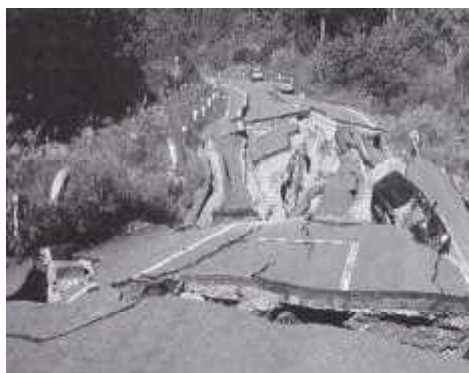
(資料8) 中越地震における道路損傷
